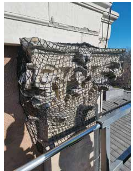
Ett antal partier och delar i fasaden är sedan lång tid nätade av säkerhetsskäl.
