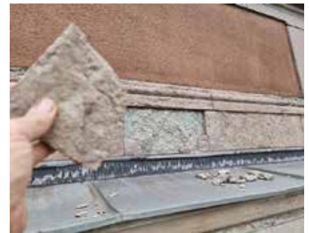
Typisk skadebild där ett lerklov skapar en svaghet i kalkstenen vilket så småningom leder till bortfall.
