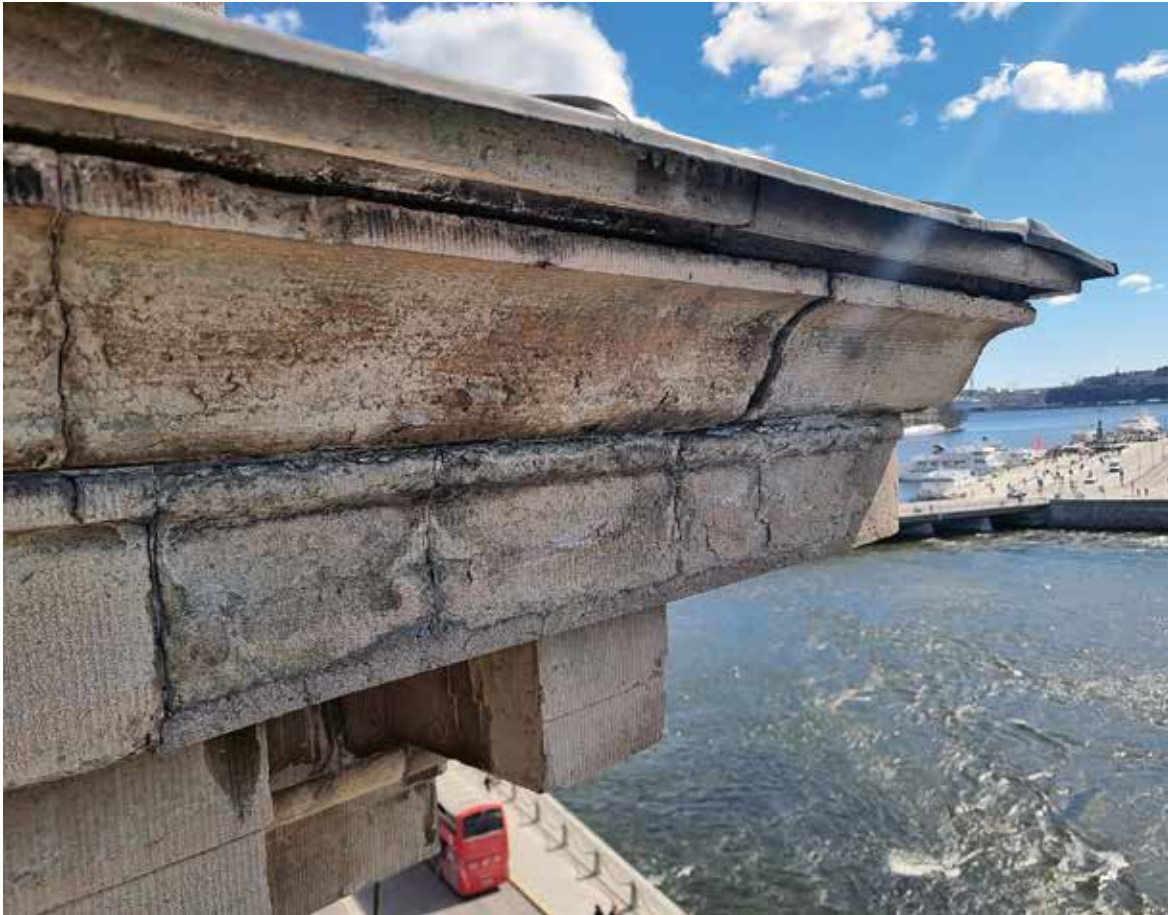
◀ Skadeinventering från lift pågår. Här ser vi vittrande kalksten, tomma bruksfogar, smutsrinningar och gamla lagningar med cementbruk.
