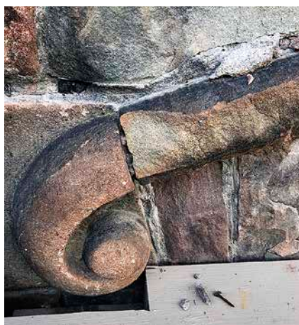
Exempel på skada på del av ett ornament.
