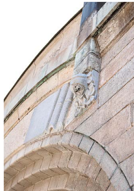
Detalj av valvbåge med skulptur där delar har bytts ut.
