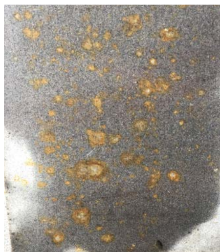
Rostfläckar på granithällen ...
