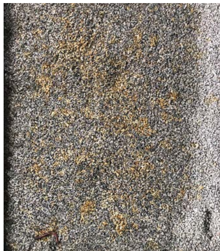
... och rost i sättlagret under hällen.
