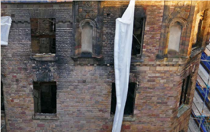
Andra våningen blev mest skadad i branden. Här ses fönster där lågorna slog ut och hettade upp valvstenarna, som sedan spräcktes av det kalla släckvattnet.
