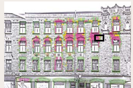
Resultatet av skadeinventeringen av den ena fasaden. Den svarta rutan visar området där stenarna demonterades för labbtester.
