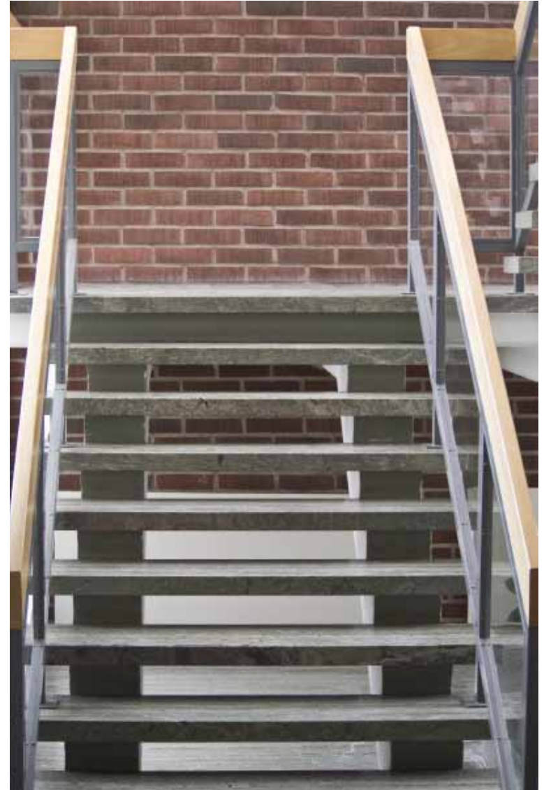
Svensk Kolmårdsmarmor i olika gröna toner var ett vanligt material i trappor och golv i mitten av 1950-talet, som t.ex. denna fribärande trappa med slipade steg, 50 mm tjocka. Starkas huvudkontor i Kristianstad.
