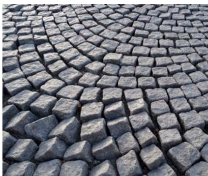
Stenkvaliteten utmärkt. Felaktigt fog- och sättmaterial. För stor finandel, vatten har blivit stående finandelen har pumpats. Bristfälligt fogunderhåll.
