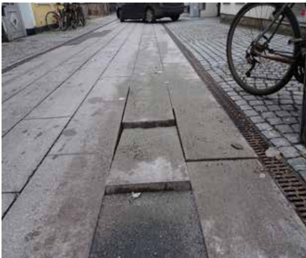
Fig 10. Fog- och sättagret har haft för stor finandel (stenmjöl) som pumpats bort och fogen och delar av sättagret har försvunnit. Distanser saknats
