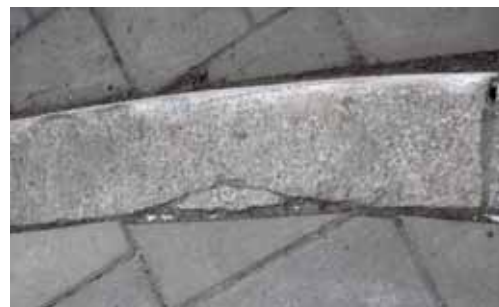
Urspjälkning på spröd sten, redan vid monteringen
